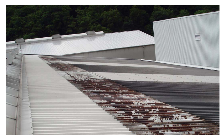
Door roest ongehinderd te laten woekeren, ontstaan er roestshades aan de verbindingen (foto's: Mansveld Schilders + HvG)
